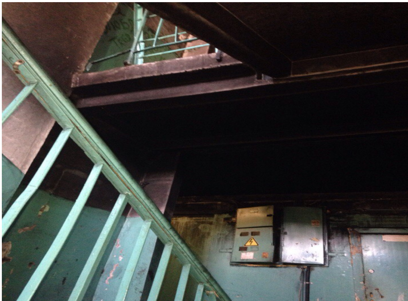
Мал. Пожар в здании цеха №1717. В результате пожара повреждены отделочные материалы и оборудование.
